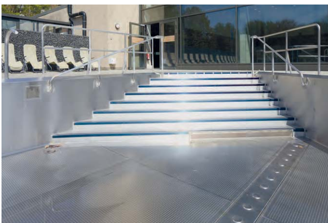
Abbildung 4: Edelstahlbecken in Freibädern nur unter Beachtung von Vorichtsmaßnahmen entleeren. (Foto: DGfdB/Dietmar Theis)
