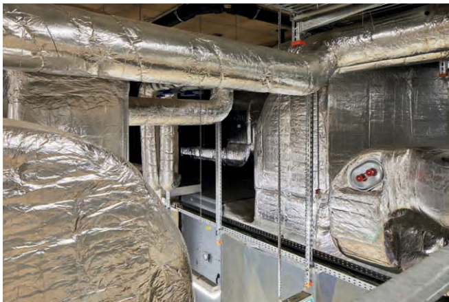
Abbildung 3: Schwimmhallen haben leistungsfähige Lüftungsanlagen, die mit hohen Luftwechselraten gefahren werden. (Foto: DGfdB/Dietmar Theis)
