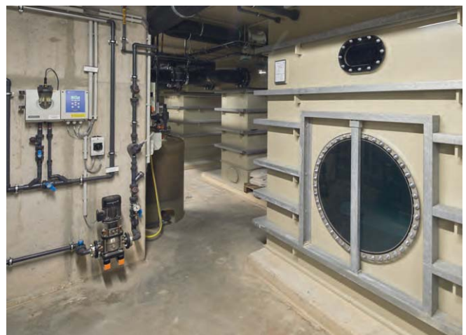
Abbildung 2: Die Schwimm- und Badebeckenwasseraufbereitung, insbesondere die Desinfektion mit Chlor, verhindert Ansteckungen über das Wasser. (Foto: DGfDB/Dietmar Theis)
