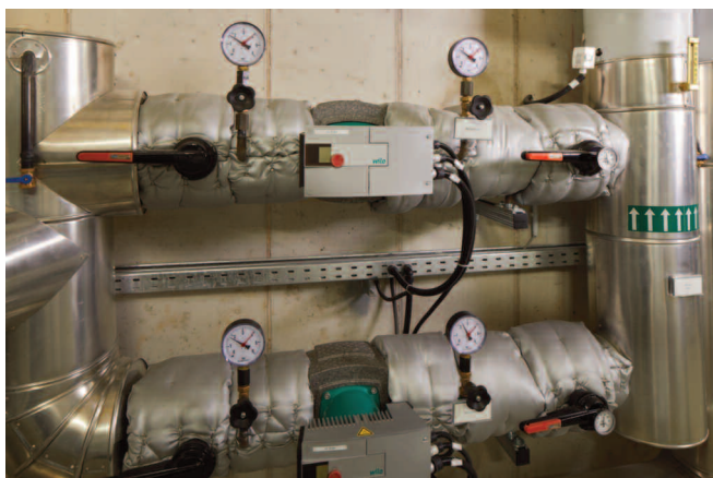
Abbildung 3: Die Heizungsanlage – Hier wird Wärme produziert
