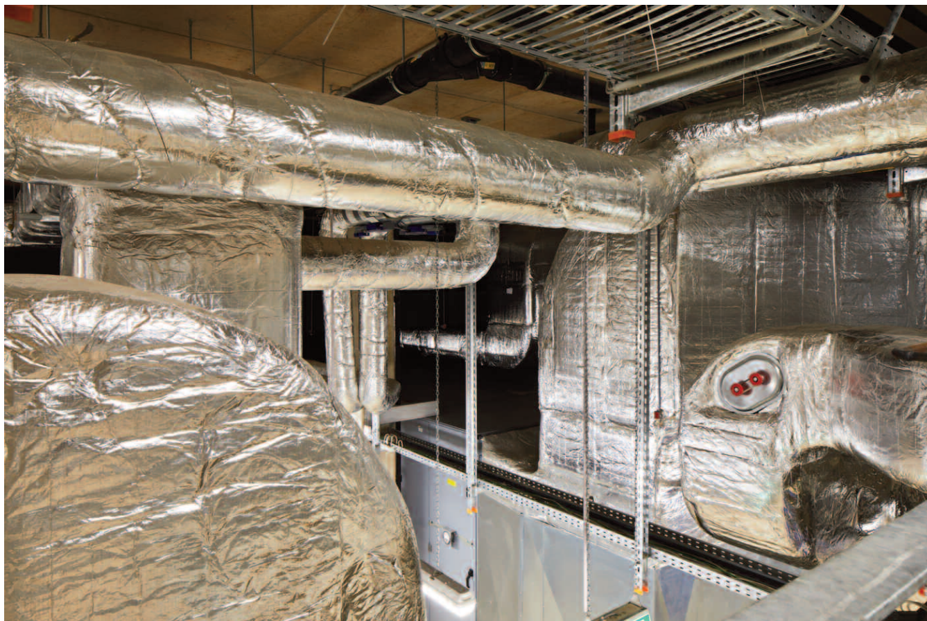
Abbildung 4: Die Lüftungsanlage – Ein Schwergewicht bei der Energieeffizienz
