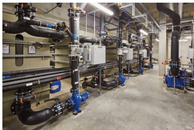
Abbildung 2: Wasseraufbereitung im Hallenbad
